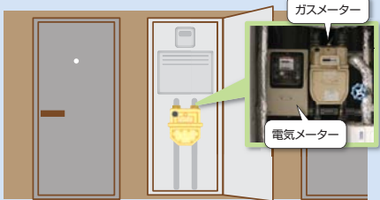
玄関脇や共用廊下のメーターボックス内に設置
