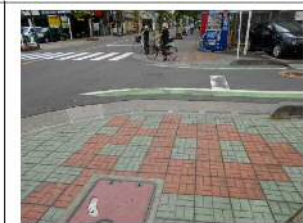
【11. 平坦部のない横断歩道接続部】
