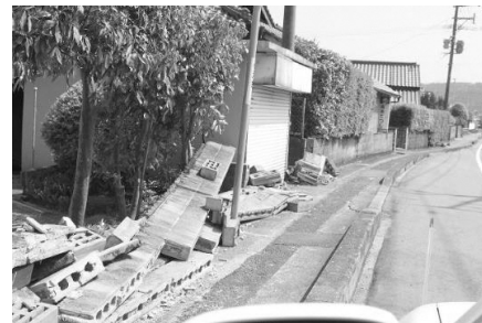
▲倒壊すると非常に危険です。
