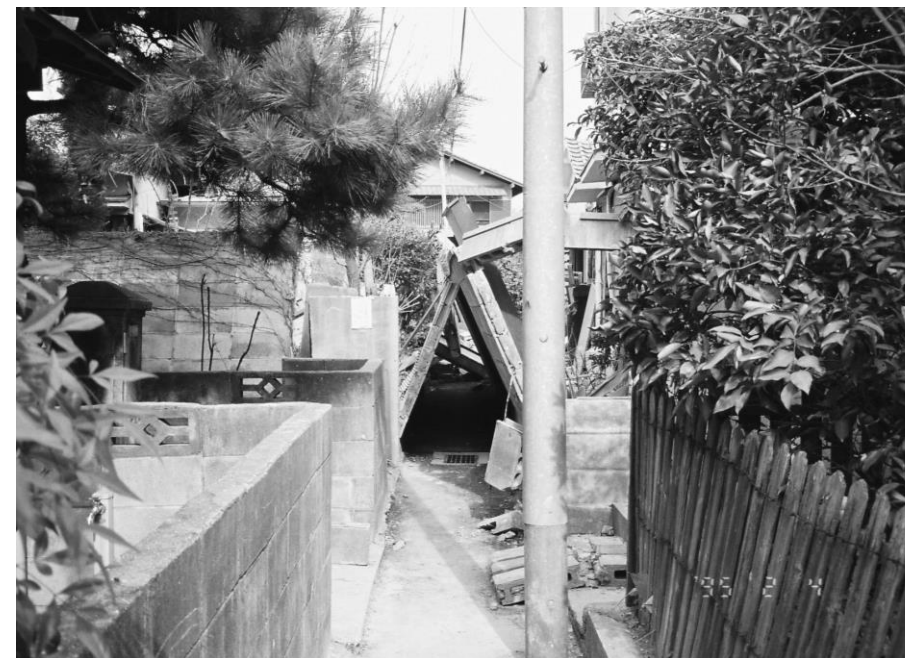
▲倒壊したブロック塀等（阪神・淡路大震災）
