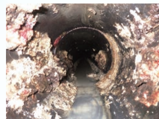
▲下水道管に付着した油脂類
