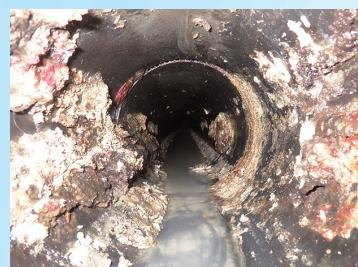
下水道管に付着した油脂類
