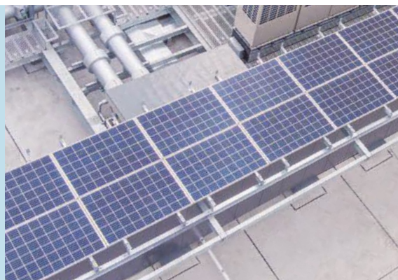
屋上 太陽光発電パネル
