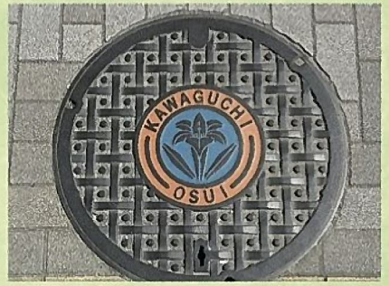
市内のマンホールの鋳物製ふた
