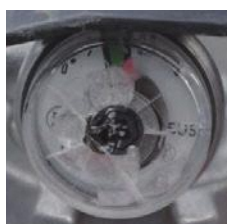
× 指示圧力計の損傷
