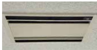
市内全小・中学校教室へのエアコン 設置
