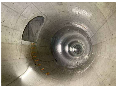
東川口貯留管
