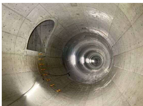
東川口貯留管
