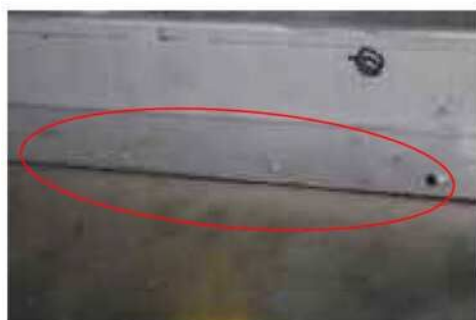
HEPA フィルタ取り付け面
