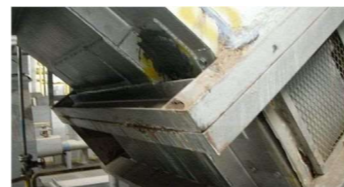
スラグコンベヤの腐食損傷補修部からの液漏れ
