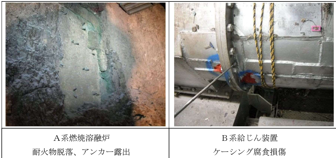
図 18-1 燃焼溶融設備の状況（抜粋）（令和3年3月精密機能検査報告書より引用）
