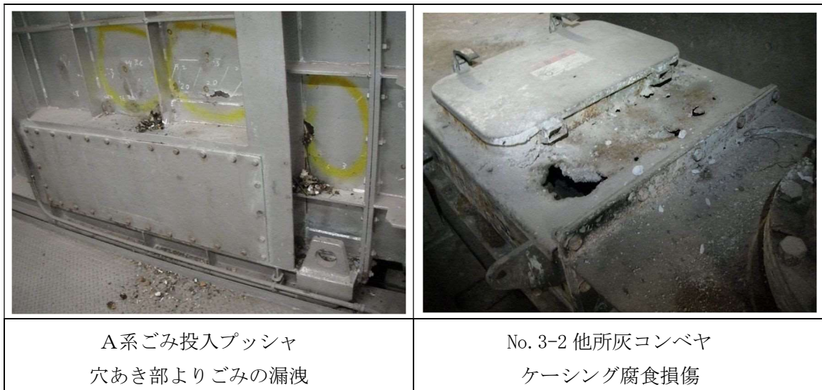
図 17 受入供給設備の状況（主に建築物）（抜粋）（令和3年3月精密機能検査報告書より引用）
