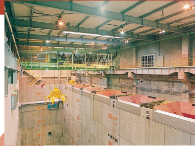
ごみピット・ごみクレーン
