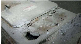
他所灰コンベヤのケーシング腐食損傷
