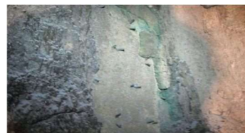
燃焼溶融炉の耐火物脱落等
