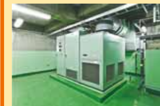
オゾン発生装置
