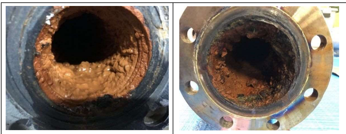
図 69 サンアール朝日の4階機械室内余熱配管の状況
