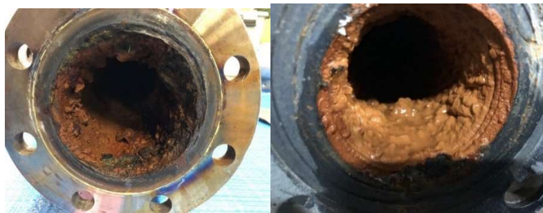
図2 サンアール朝日の劣化状況（配管類）
