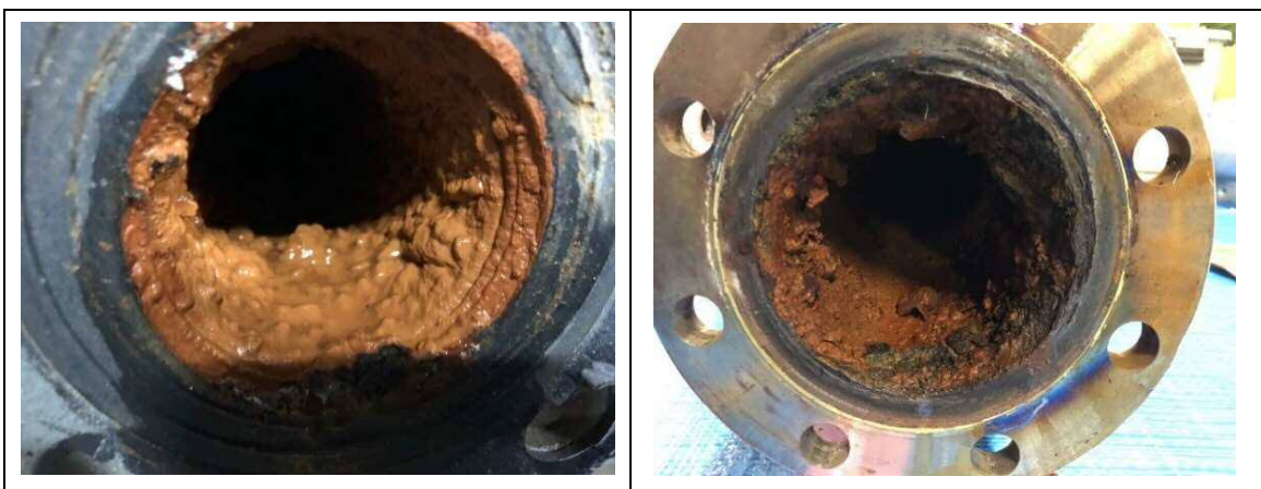
図 1-4 サンアール朝日の4階機械室内余熱配管の状況
