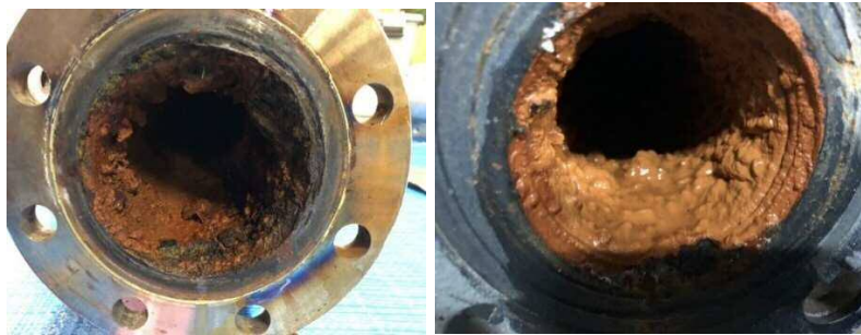
図 4-30 サンアール朝日の4階機械室内余熱配管の状況
