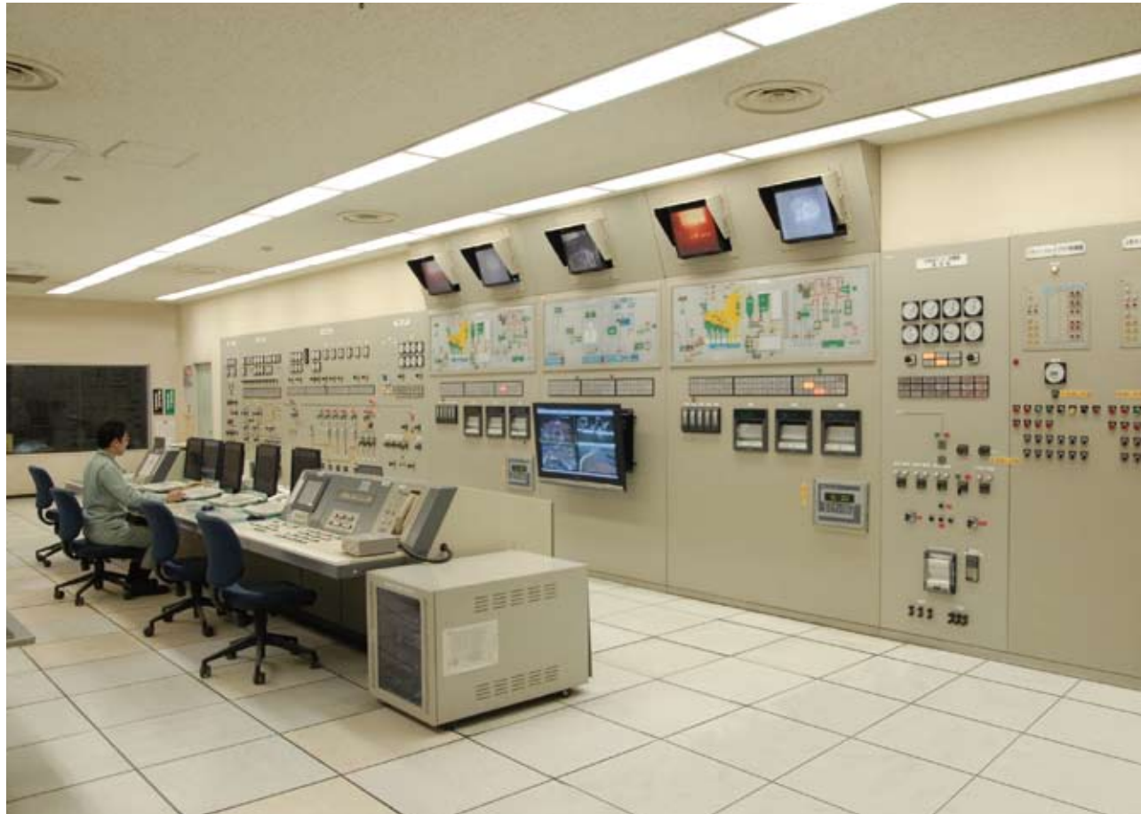
▲中央制御室 Central control room
