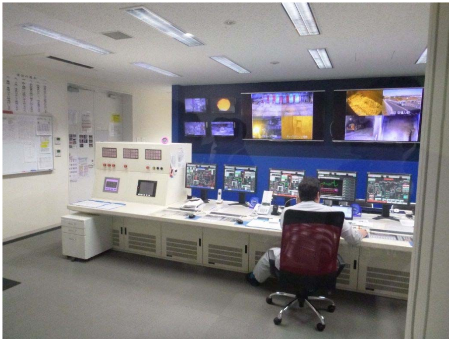
熱回収施設中央制御室
