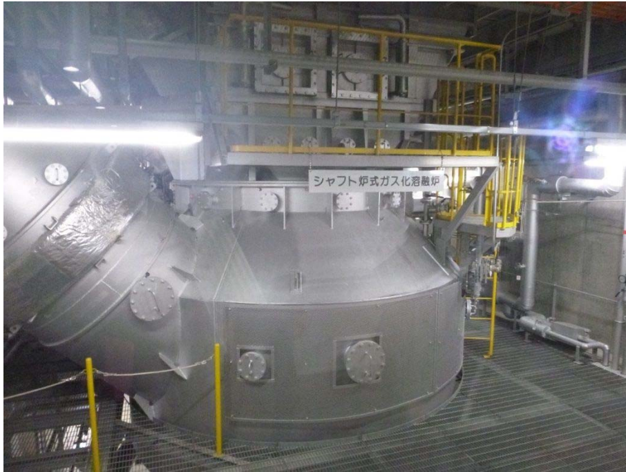
シャフト炉式ガス化溶融炉
