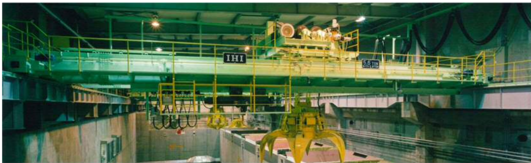
写真5. No. 2 ごみクレーンガーダ
