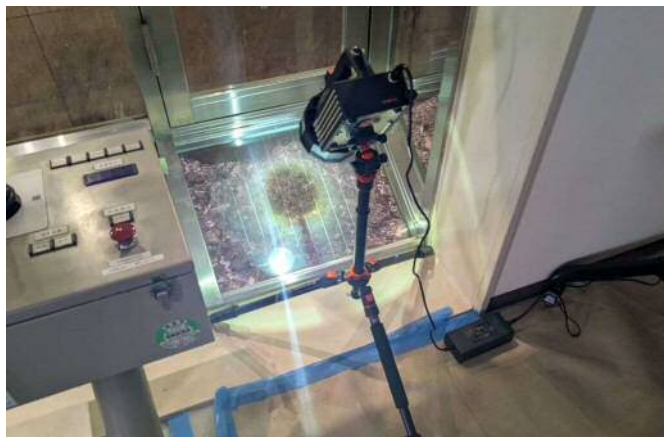
写真 18. 停電時用スポット照明
