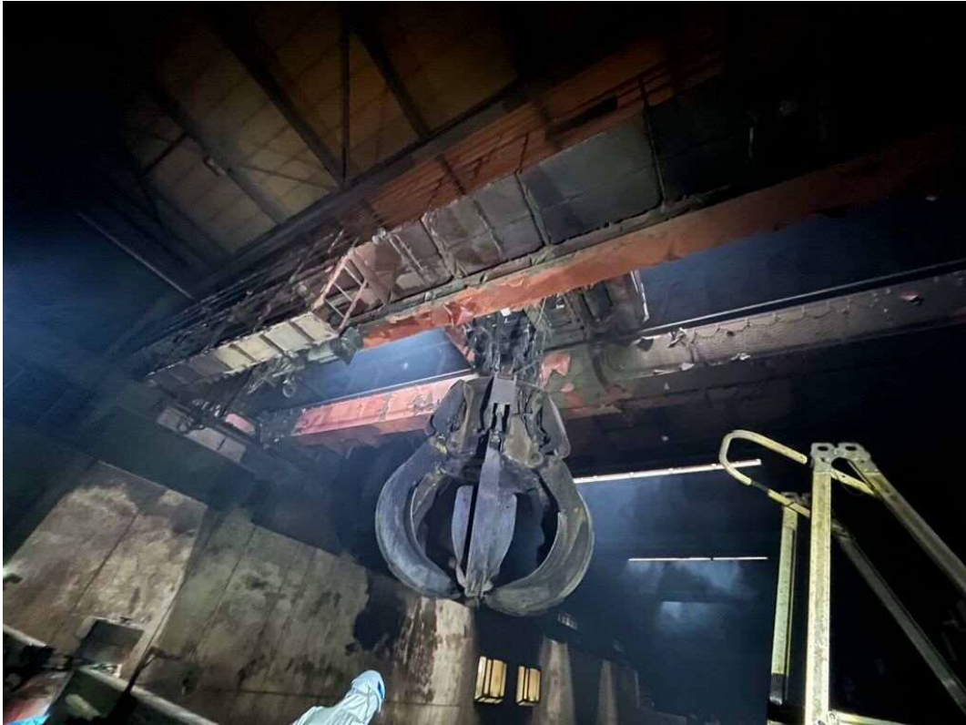
写真2. No.1 ごみクレーン
