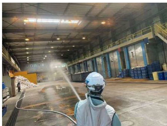
写真 13-2. プラットホーム屋内消火栓訓練②
