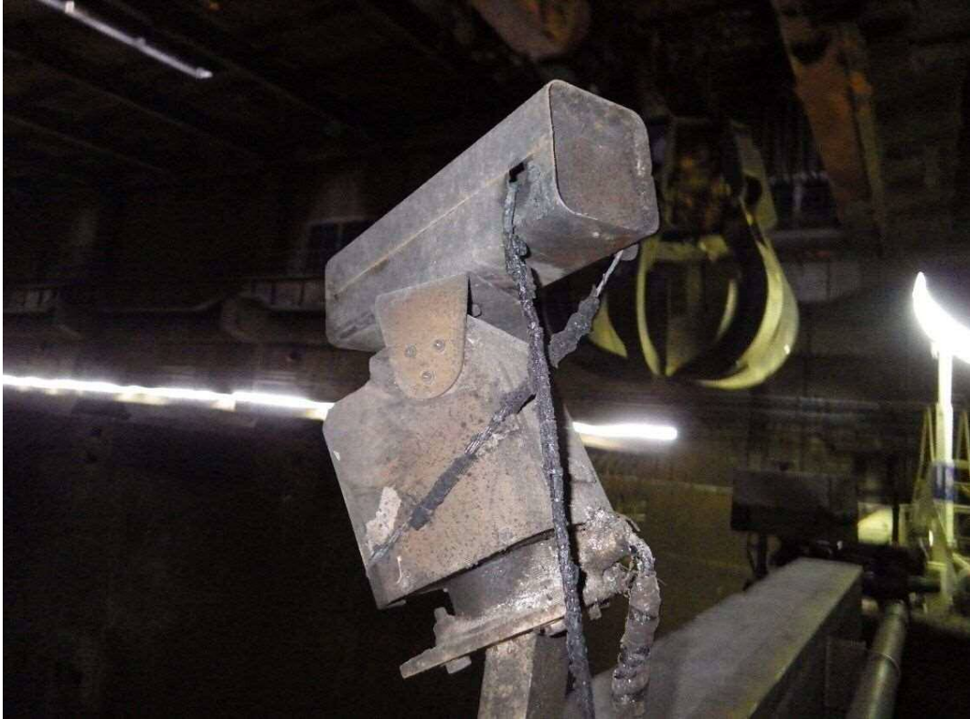
写真 8. ごみピット用監視カメラ
