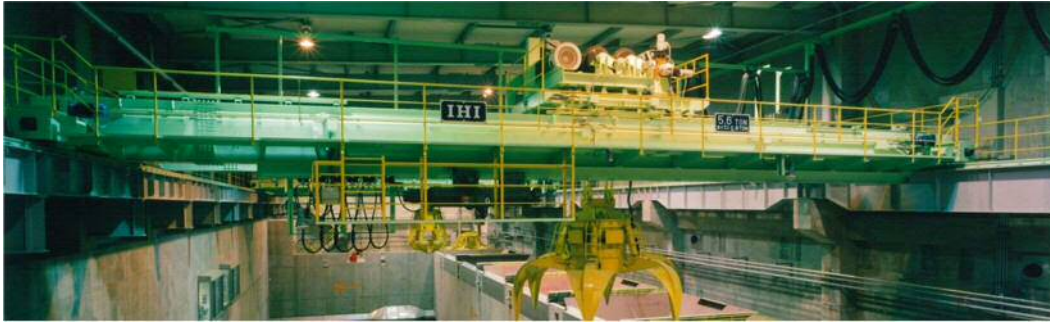
写真4. No. 1 ごみクレーンガーダ
